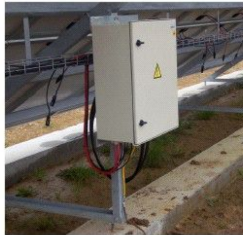
Figura 26: Caja de conexión de grupo.
