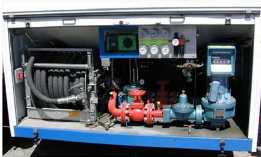
Figura 12 Armario de válvulas de carga y descarga. [13]
