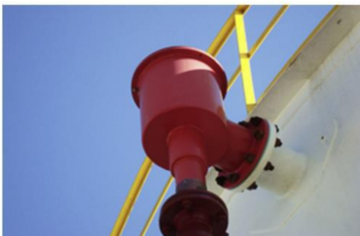
Ilustración 41. Cámara de espuma en tanque de almacenamiento
