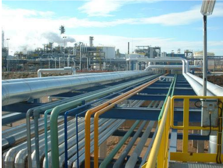
Ilustración 19. Racks de tuberías
