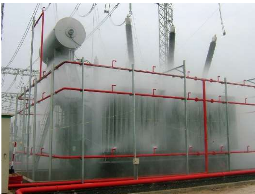
Ilustración 1.7.2.4-1 Sistema extinción por agua pulverizada funcionando
