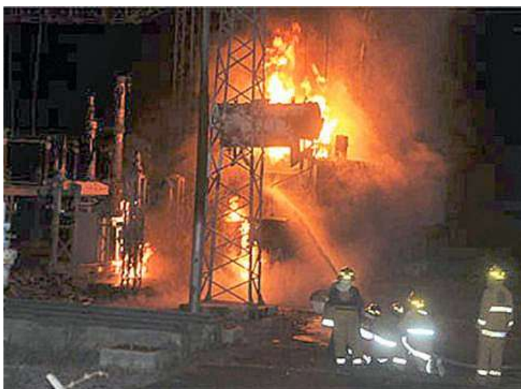
Ilustración 1.5.3.3-1 Incendio de un transformador
