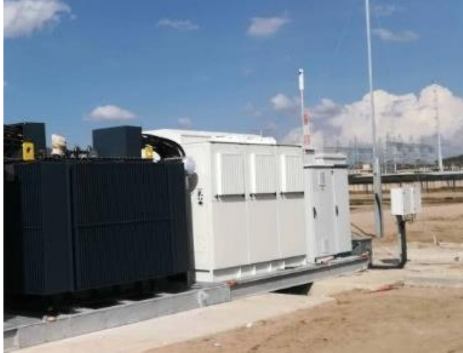
Figura 16: Transformador Ormazabal junto a inversor Jema.
