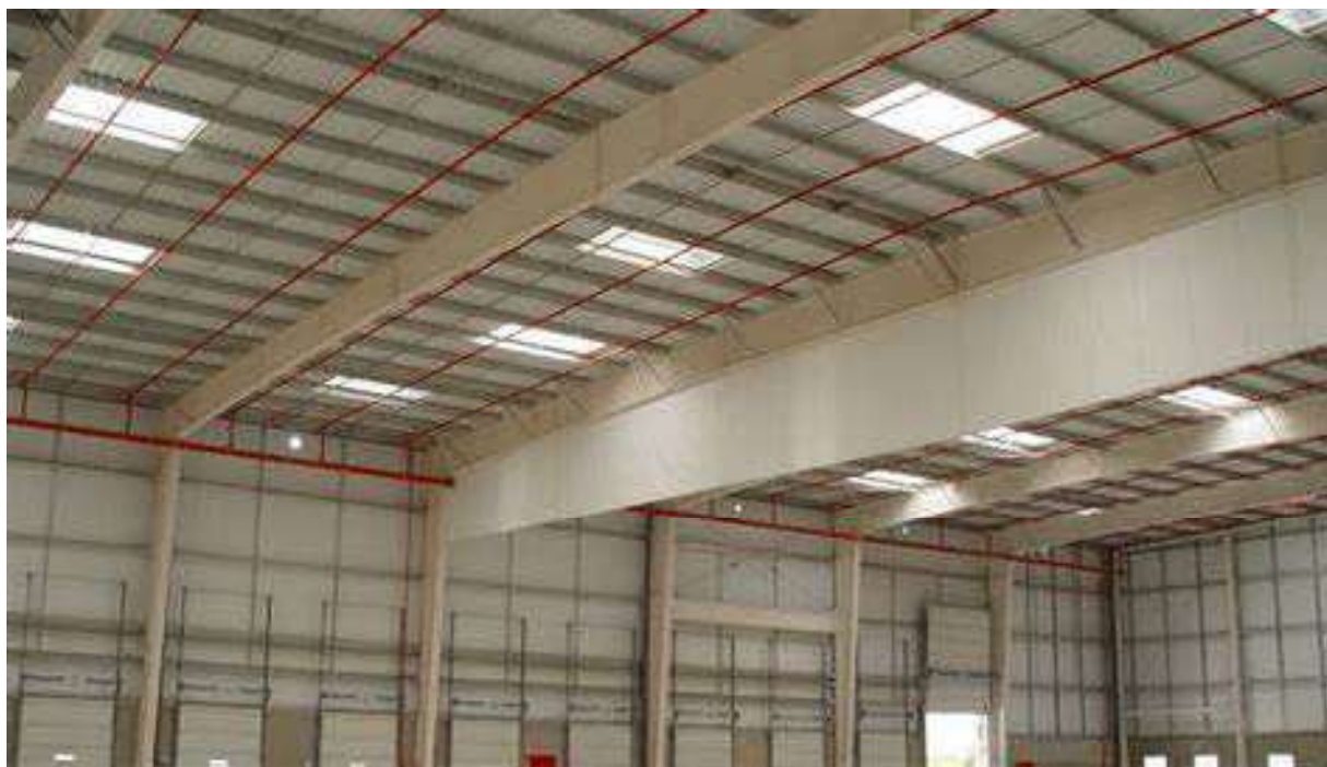
Figura 59. Ejemplo de una barrera de humo fija en un establecimiento logístico (Fuente: Web del distribuidor APSFIRE – www.apsfire.es )
