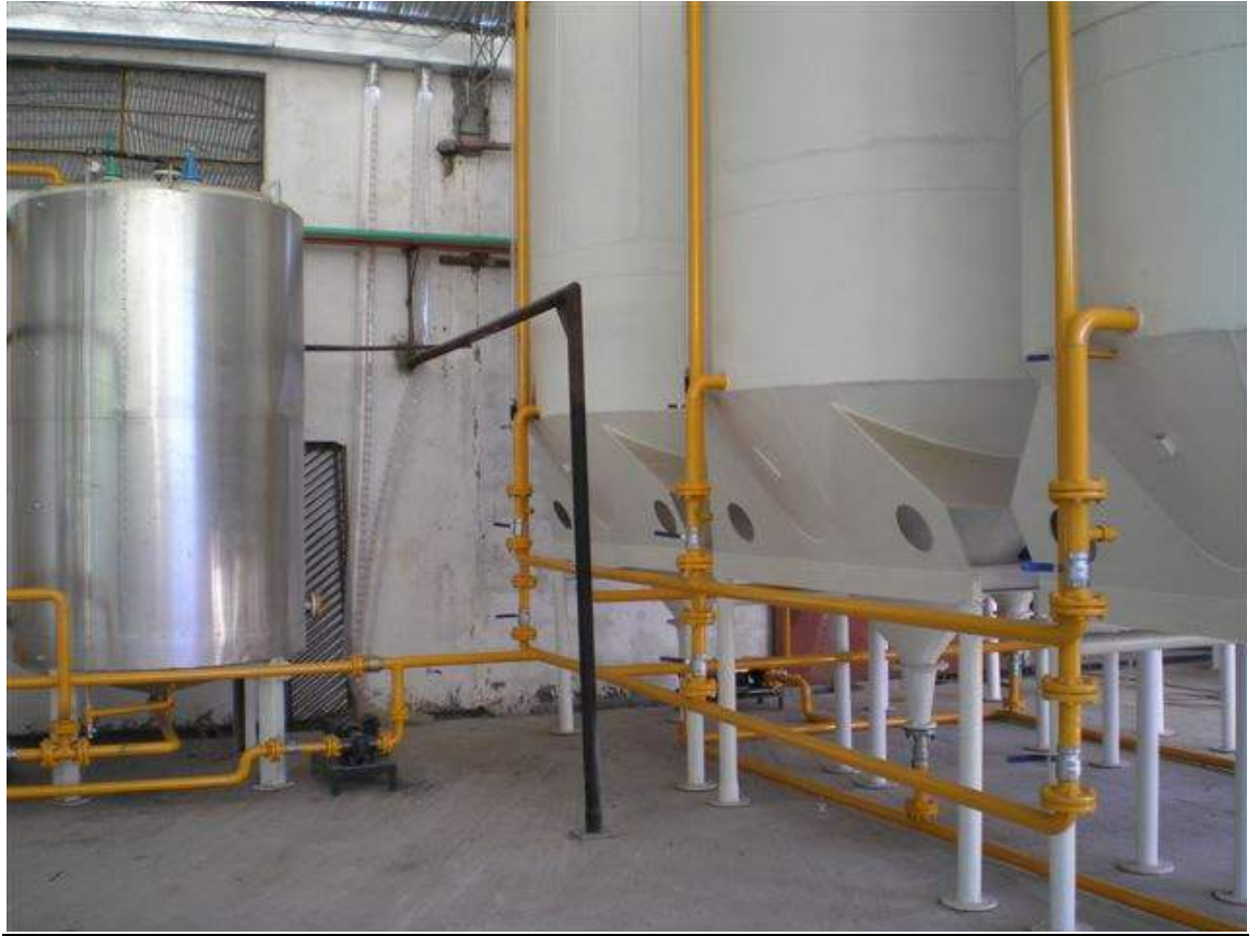
Figura 69, Detalle reactor y decantadores
